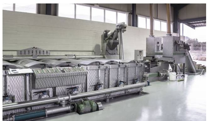
Überwachung in Produktionsanlagen wie Ölpresen
